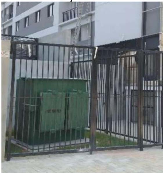
Figura 8 – Foto do local da instalação do transformador em pedestal
