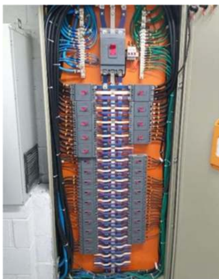
Figura 10 – Foto Quadro QLE- COB
