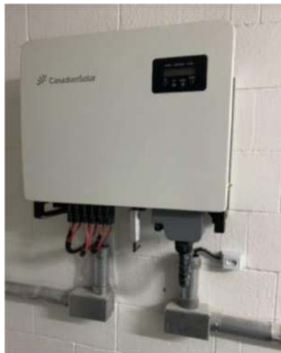
Figura 23 – Foto Inversor fixado
