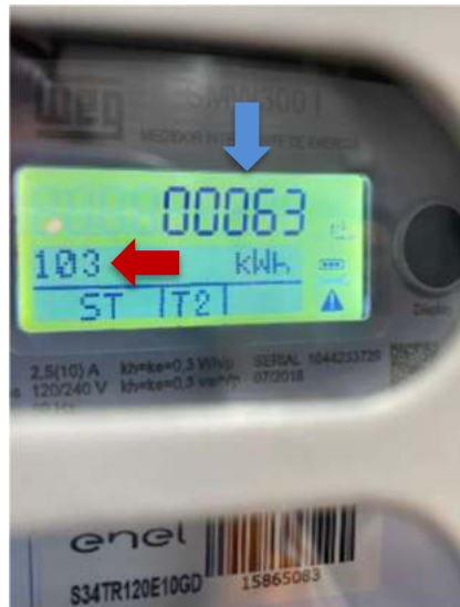
Figura 27 – Detalhe do Medidor Bidirecional, medição energia injetada
