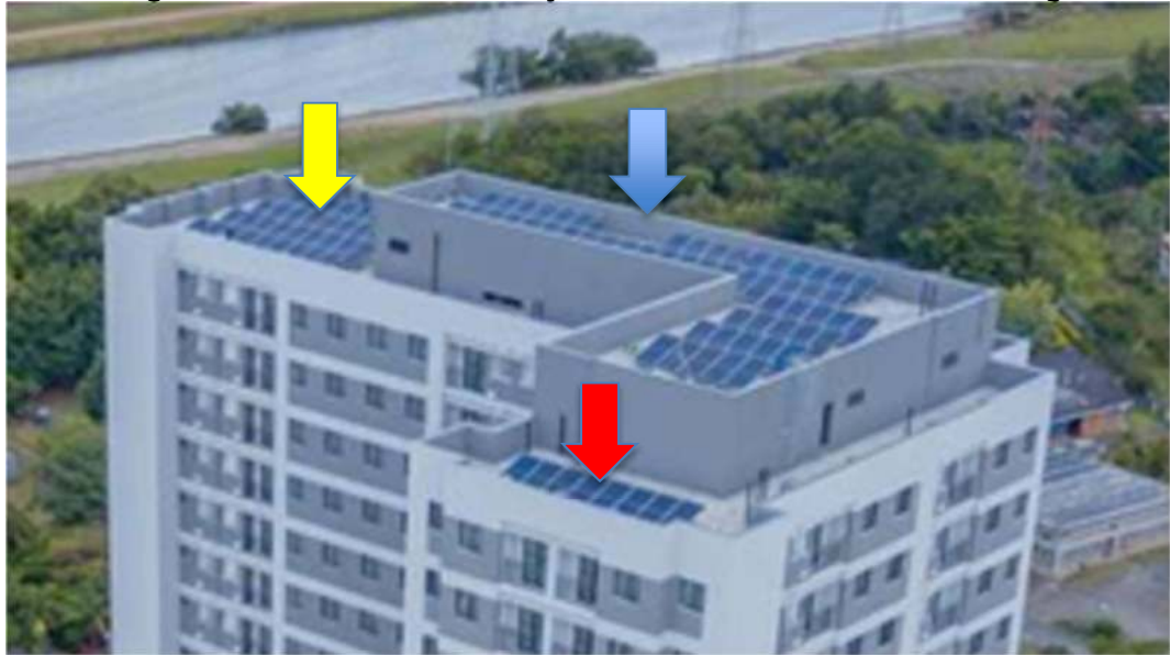
Figura 29 – Detalhe diferença de nível barrilete x cobertura geral
