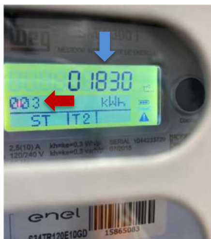
Figura 26 – Detalhe do medidor bidirecional, medição energia consumida
